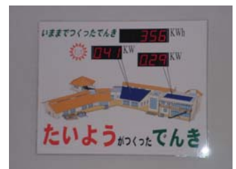
太陽光発電電力表示装置
